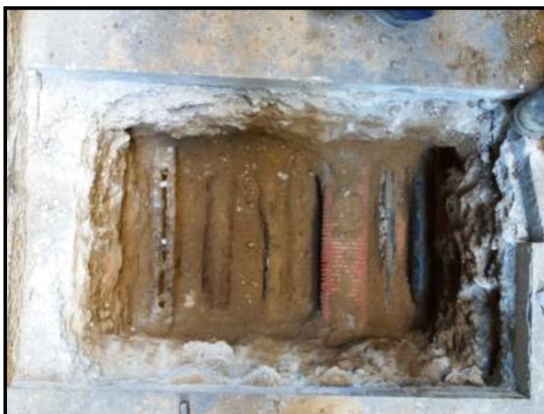
Fotografia 2. En aquesta fotografia es poden observar la quantitat de serveis que van deixar al descobert els treballs.
