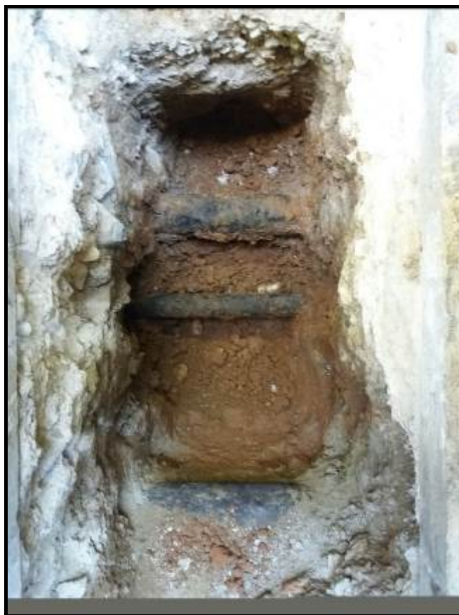
Fotografia 6. Altra tram de la rasa un cop fet el buidatge on es pot veure els serveis que es trobaven en aquesta zona.
